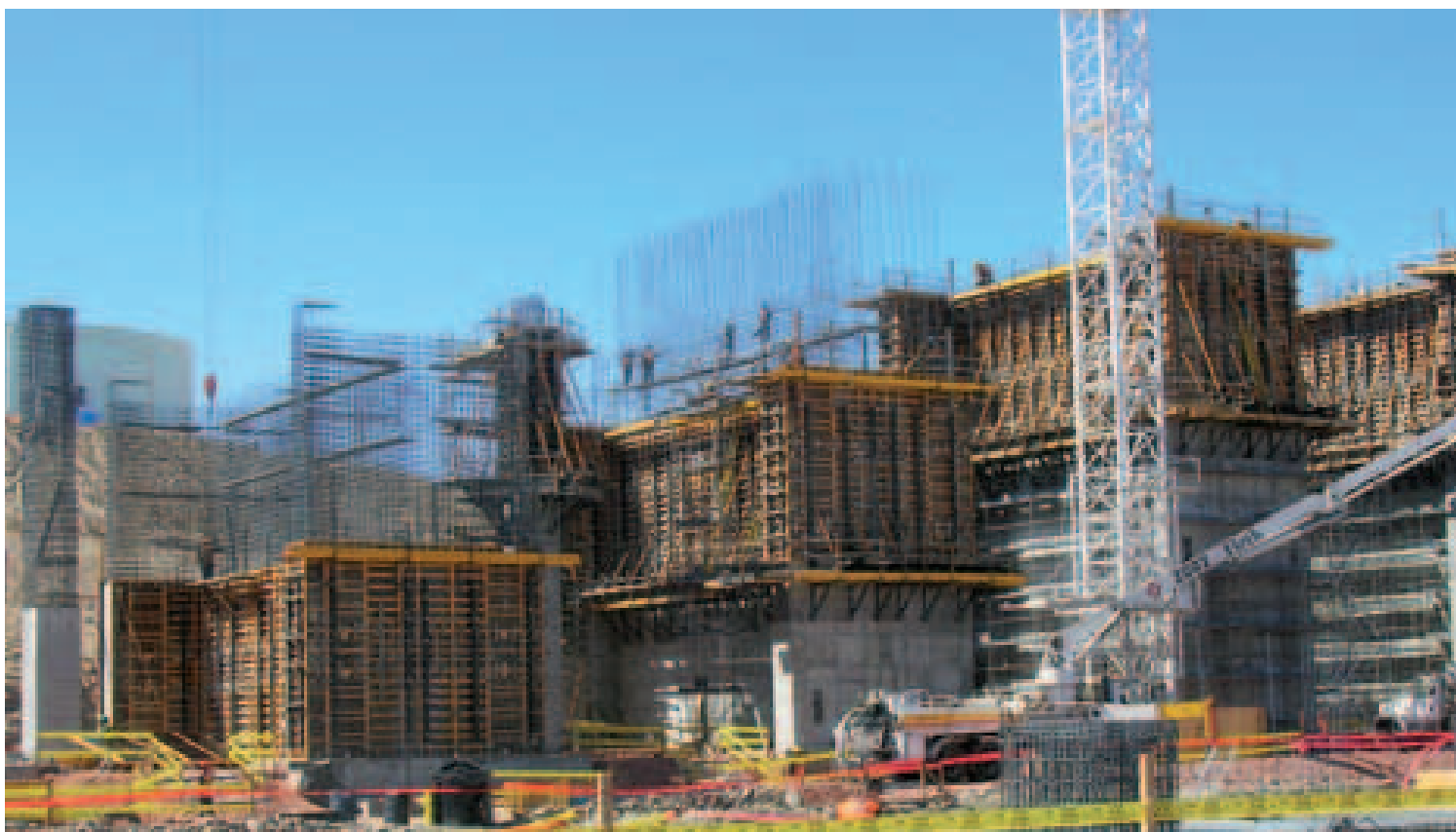
Planta de Sulfuro Primario Mina Cerro Verde, Arequipa, Perú
